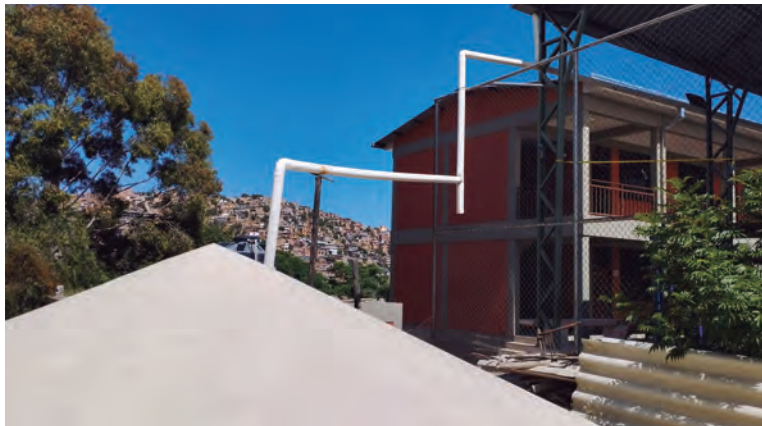
Conexión de tubos a los tanques de almacenamiento. El agua es utilizada para el riego de plantas y la limpieza de los baños de la Unidad Educativa "Vikinga Boliviana".
