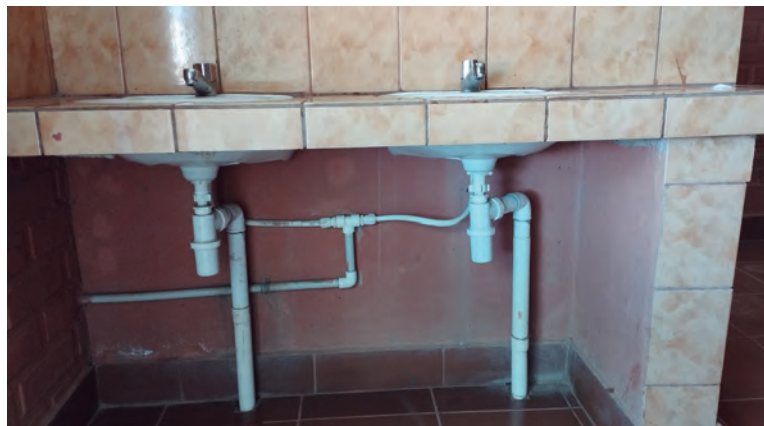
Sistema de distribución del agua de lluvia almacenada en los tanques.
